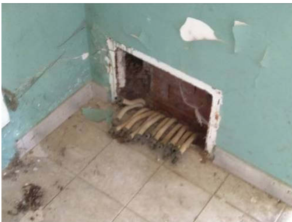
Derivazioni per impianto di riscaldamento
