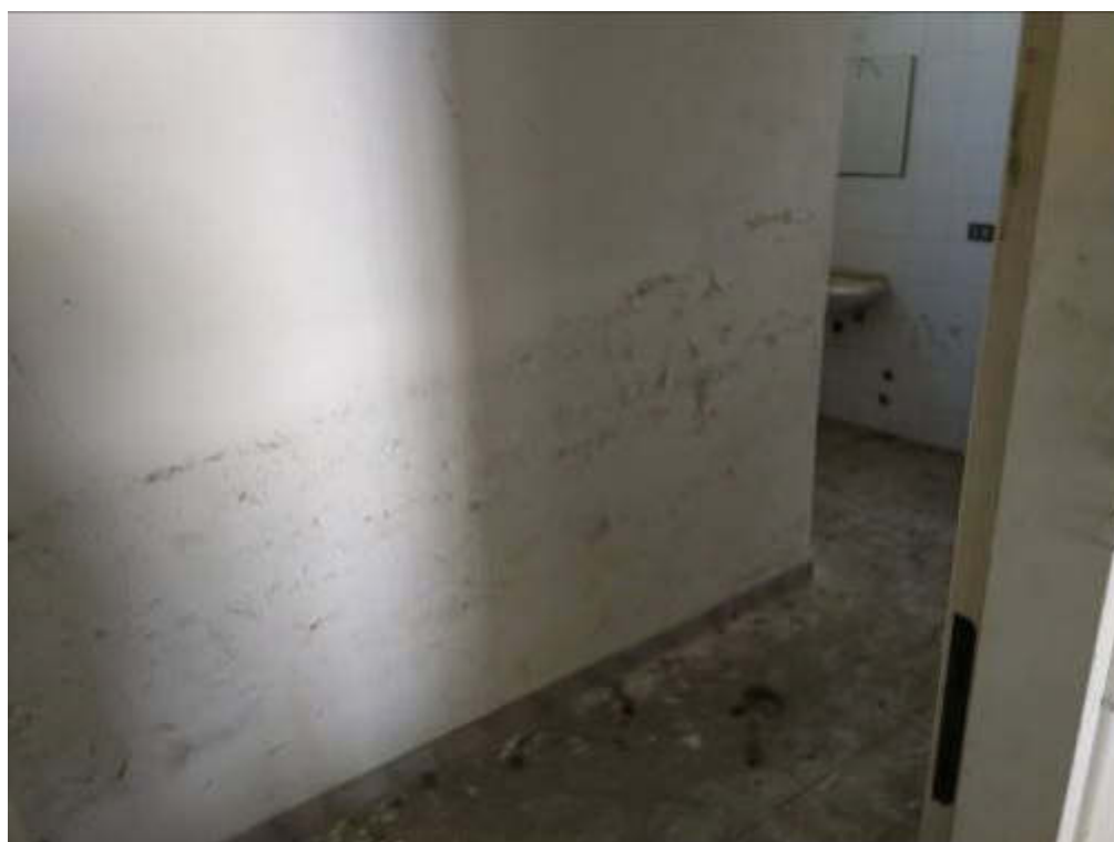
Segni di umidità di risalita
